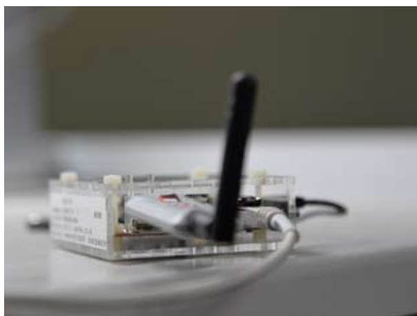
機房中的無線傳輸和各類感測器，提供溫濕度及二氧化碳濃度等資訊。
